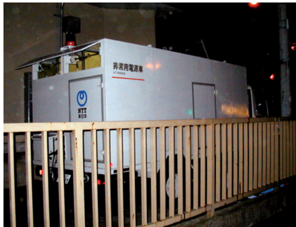
移動電源車による停電ビルへの電源救済
