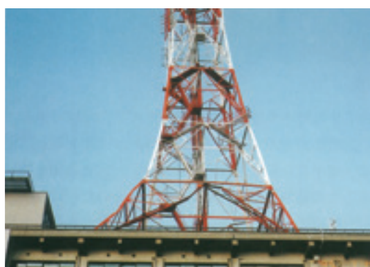
写真2 論文の紹介スライドの一部（阪神・淡路大震災時の鉄塔の様子） 4)
