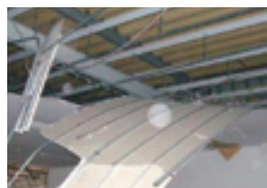
図7 クリップがはずれによる天井落下
