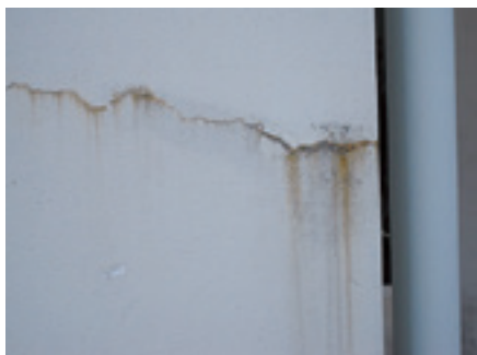
写真3 塗装壁に生じたクラック
