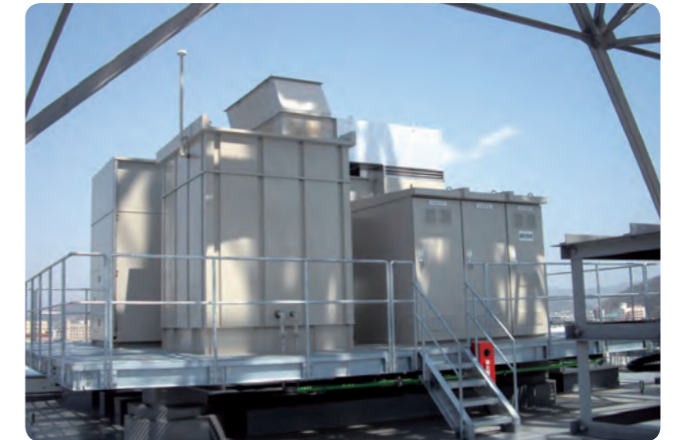
屋上に設置した非常用発電機
