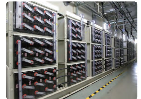
更改した蓄電池
