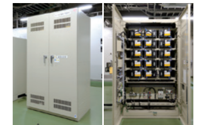
リチウムイオン蓄電池
